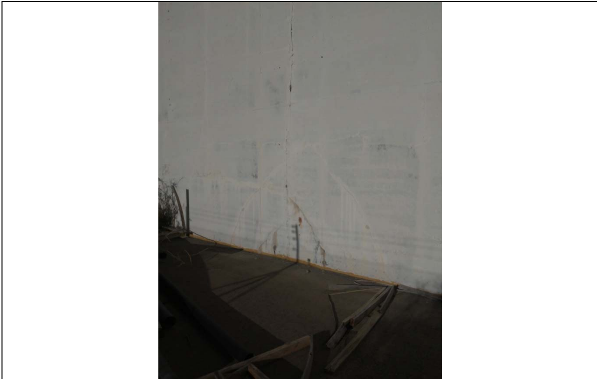
Vista exterior de una de las fisuras
