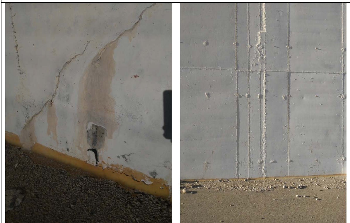
Vista de una fisura por donde actualmente "escapa" el agua
