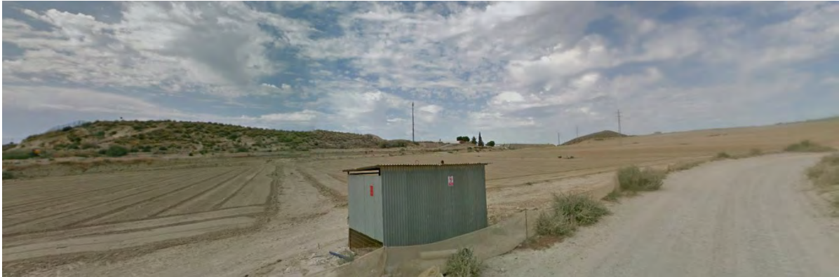
** ARQUETA INICIO DE CONEXIÓN CON TRAMO DE TUBERÍA EXISTENTE QUE CONECTA CON TUBERÍA PROCEDENTE DE DESALADORA DE CARBONERAS EN RÍO ALMANZORA.
